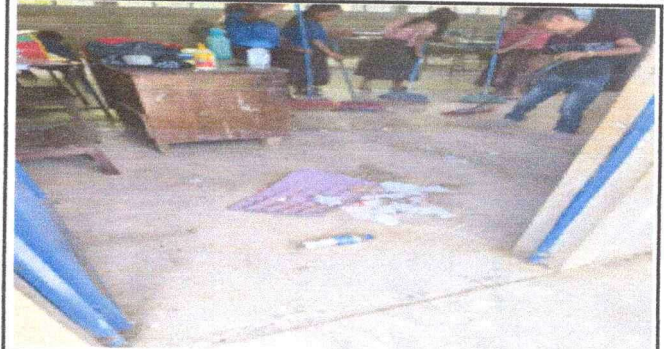
Foto 2: aquí podemos observar a los niños realizar el aseo, pero este tipo de entortado emana demasiado polvo por lo que por seguridad de la salud de los alumnos se procedera a colocar piso ceramico.
