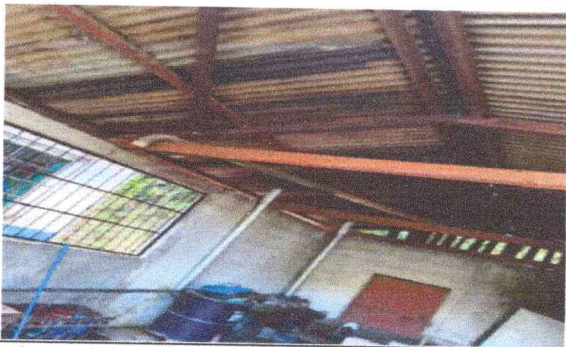
Foto 3: observamos que la madera y la lamina de la cocina ya estan dañadas por lo que se procedera a sustituirlo por estructura metalica y lamina troquelada
